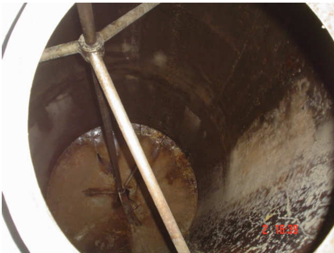
Figura 5.9: Detalhe de sujidade e dos misturadores em um dos tanques.
